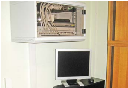
Server und Netzwerk erneuert
