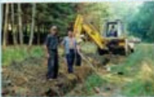
Verbindungsleitung Tubl - Med-Mosta
